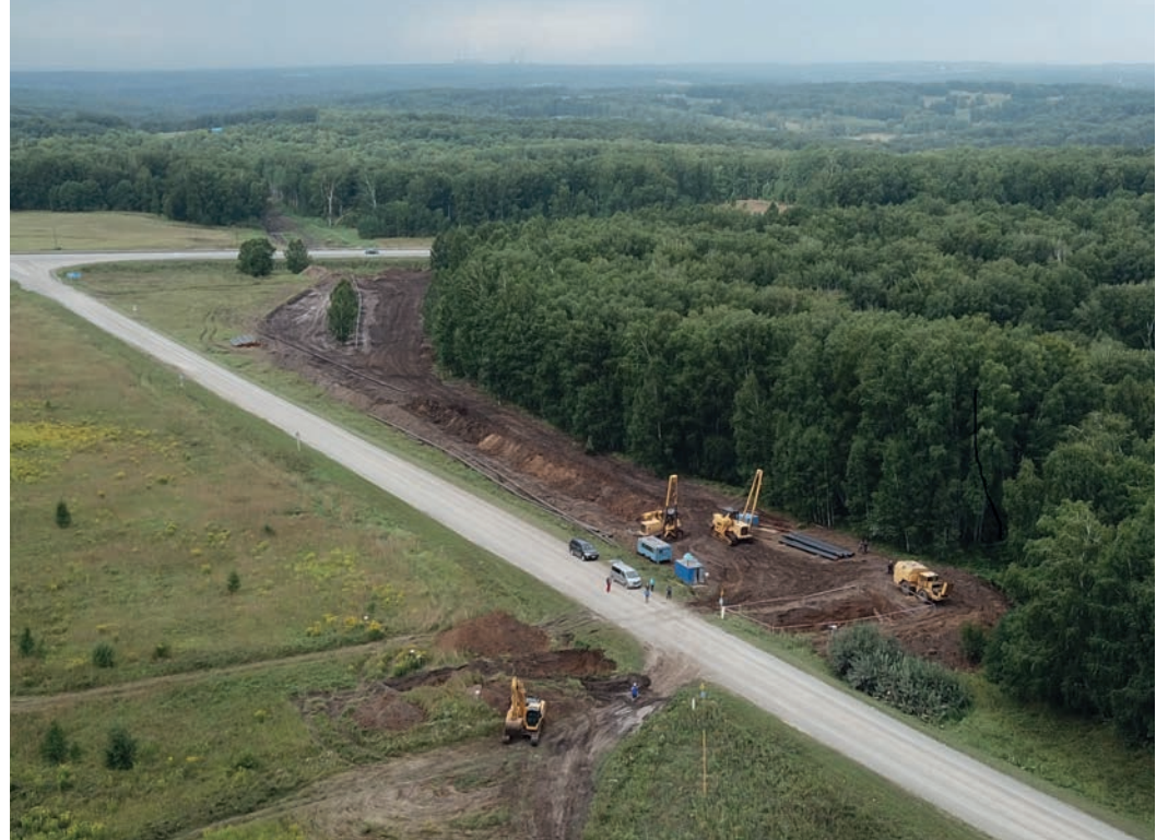
Прокладка трубы под автодорогой на Жеребцово (на переднем плане) и под трассой Новосибирск – Ленинск-Кузнецкий
