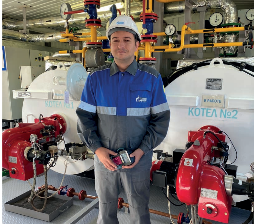
Разработка инженера Камчатского ЛПУМГ Евгения Ватутина позволила увеличить надежность котельной и тепловых узлов
