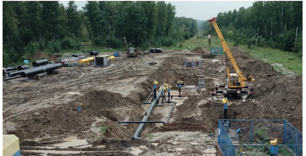
В таких условиях шло строительство камеры приема-запуска очистных устройств около с. Черепаново
