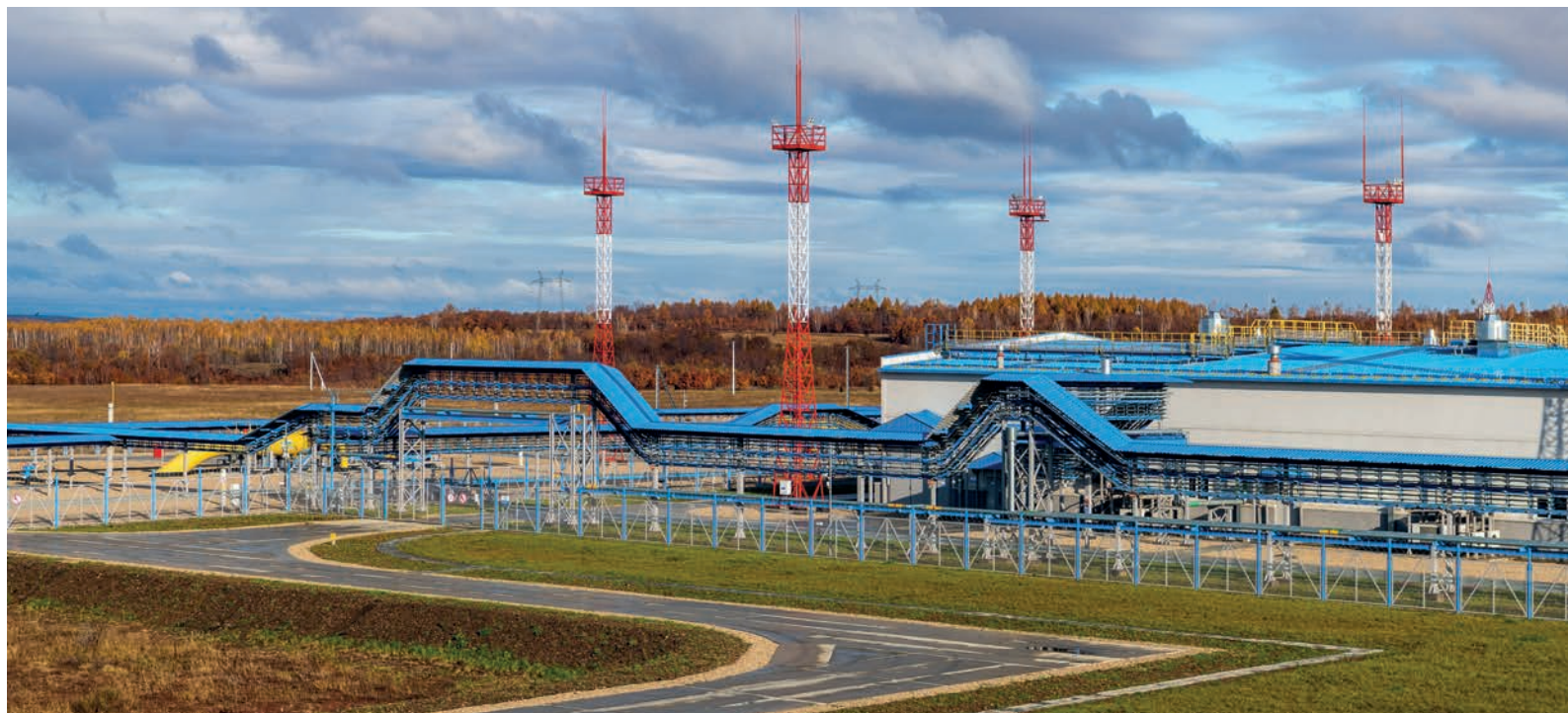
Газоизмерительная станция около Благовещенка – последний рубеж перед переходом газа, транспортируемого по «Силе Сибири», в Китайскую Народную Республику
