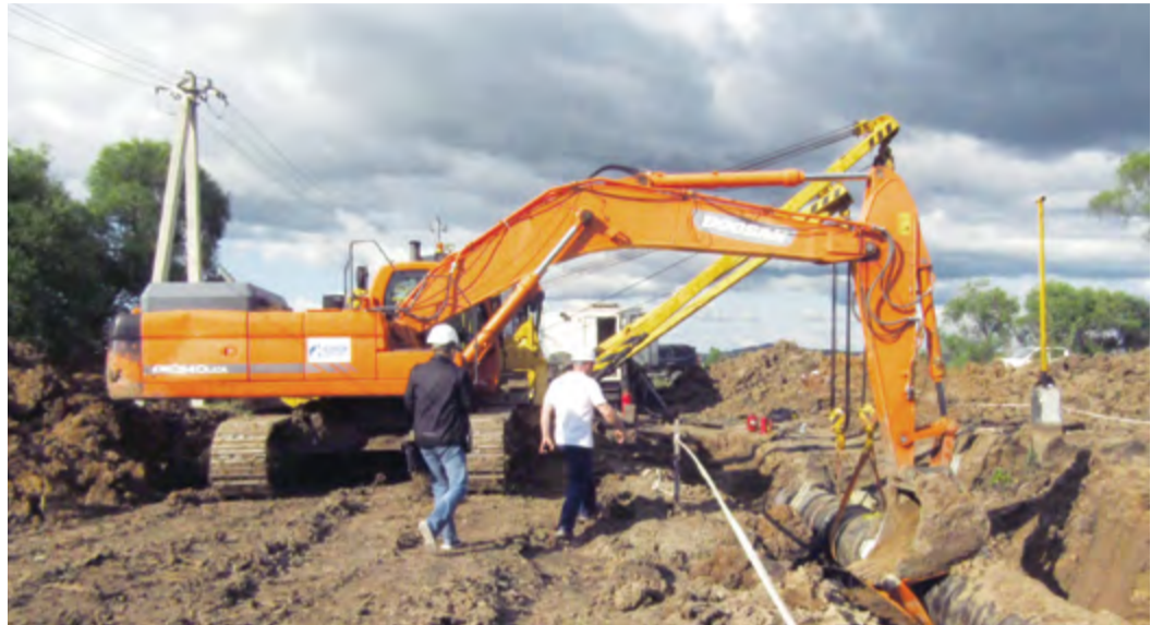
Ремонтные работы на магистральном газопроводе Сахалин – Хабаровск – Владивосток в районе села Орловка Приморского края
