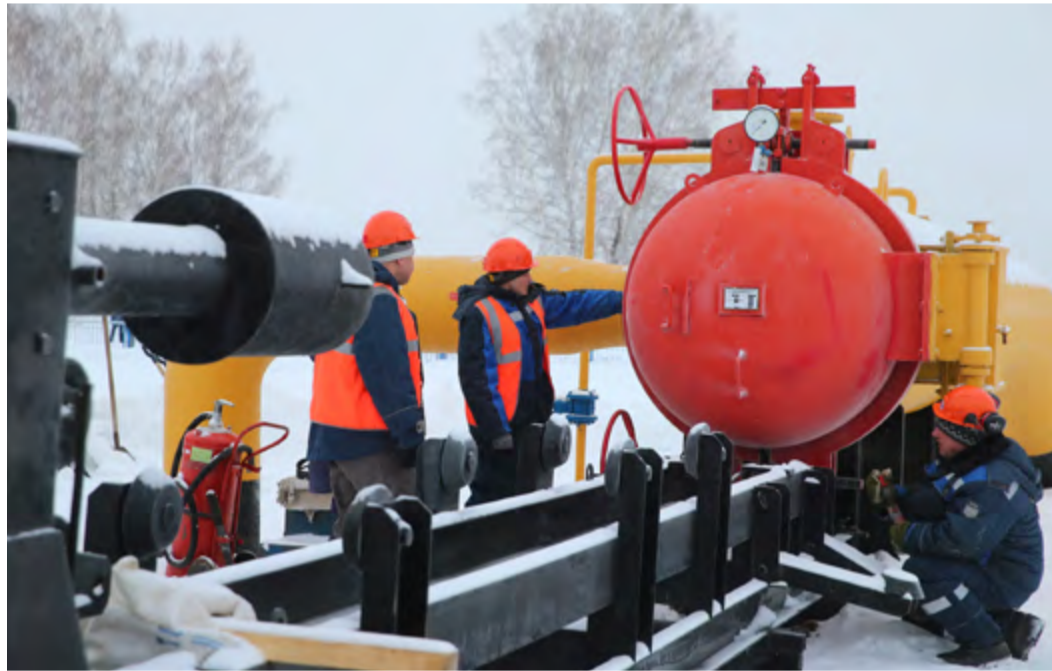
Затвор на камере запуска закрыт. После нагнетания давления дефектоскоп начнет путь
