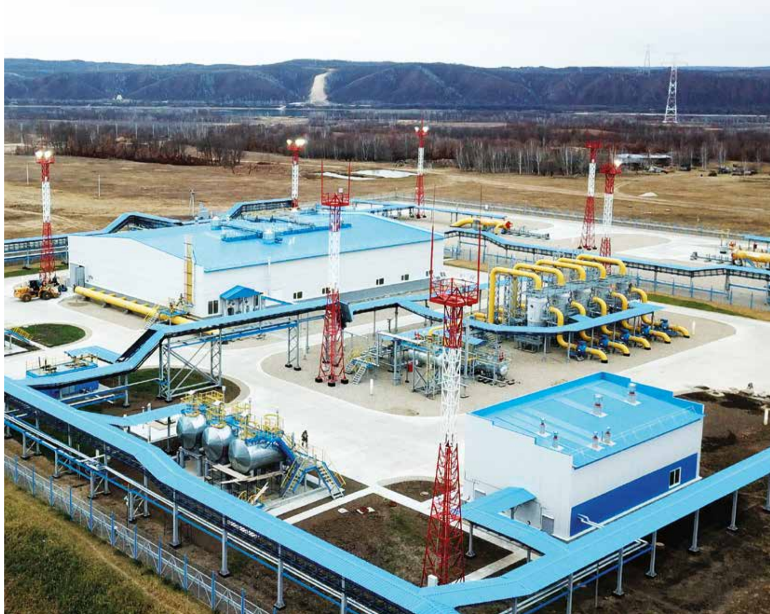
Газоизмерительная станция возле г. Благовещенска
