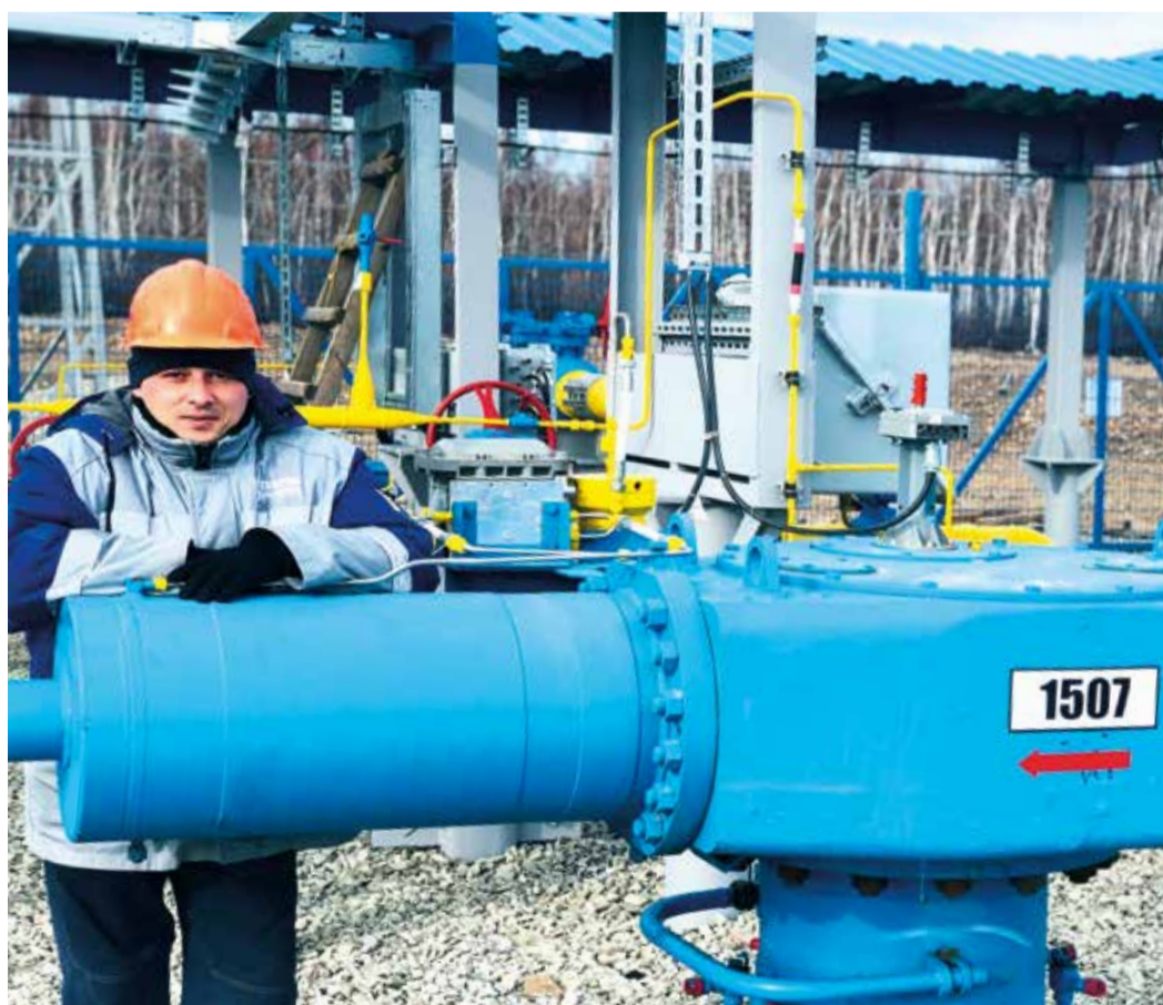
Линейный трубопроводчик Борис Шурыгин на крановом узле 1507 в зоне ответственности Сковородинского ЛПУМГ
