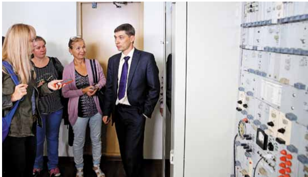
Начальник службы технологической связи Кемеровского ЛПУМГ Дмитрий Левченко показывает журналистам модернизированный аппаратный зал: теперь все оборудование там – цифровое
