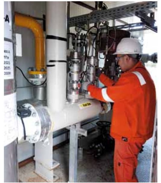
Калибровка датчиков давления установки топливного газа
