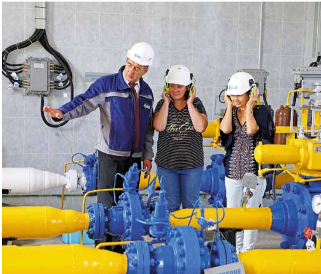
ГРС-1 обеспечивает подачу газа гиганту химической промышленности – КАО «Азот»
