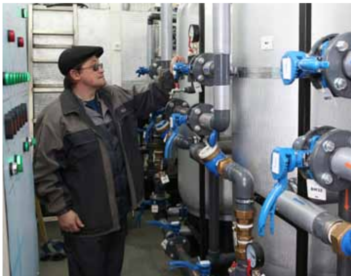
Станция очистки воды в селе Александровском
