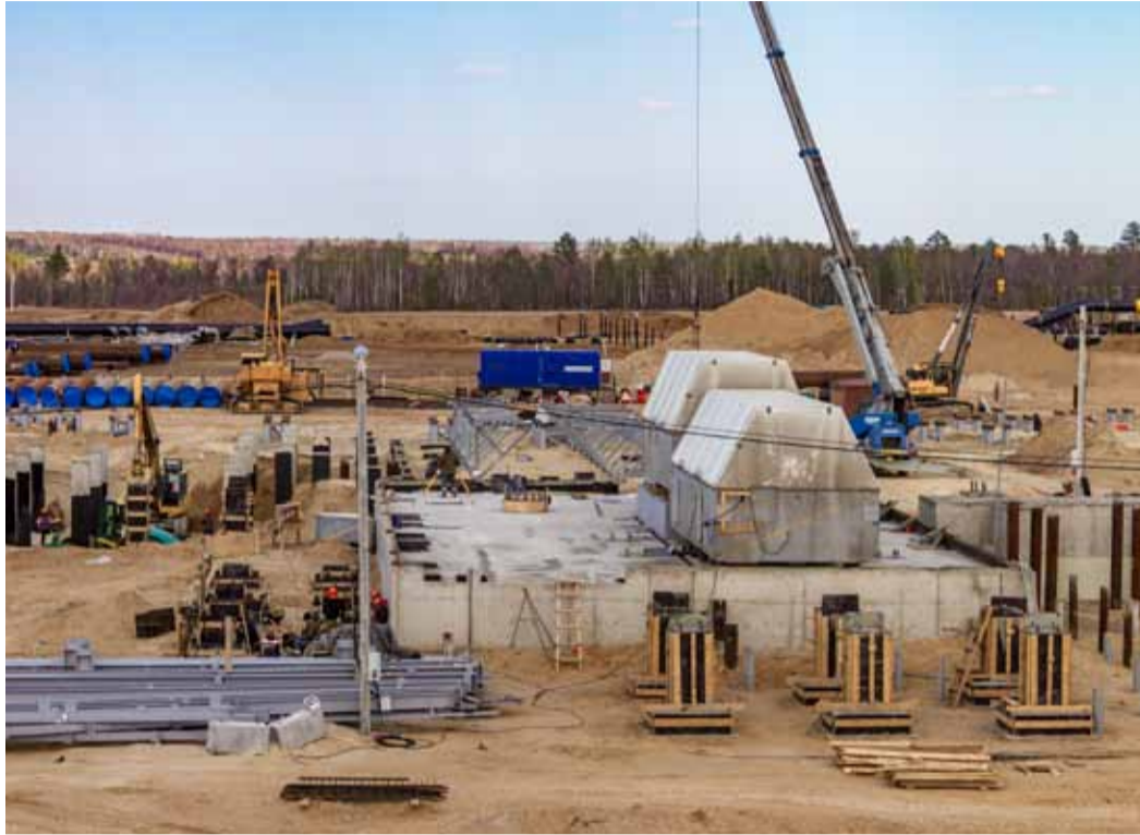
Установка ГПА-32 «Ладога»
