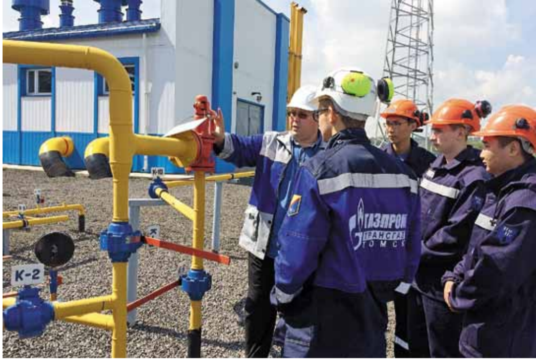
Студенты ТПУ осваивают навыки операторов ГРС на ГРС-1 города Новокузнецка
