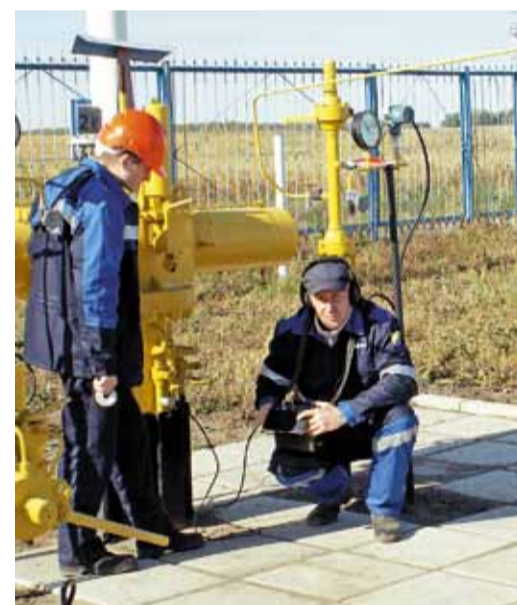
Диагностика герметичности трубопроводной арматуры
