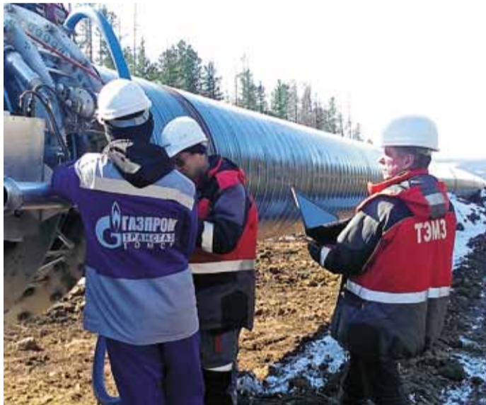
ЗАО «ТЭМЗ им. Вахрушева» работает с ПАО «Газпром» над внедрением новых технологий
