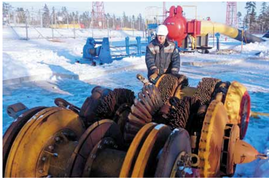
В 2016 году методом внутритрубной диагностики было обследовано более 2000 километров газопроводов
