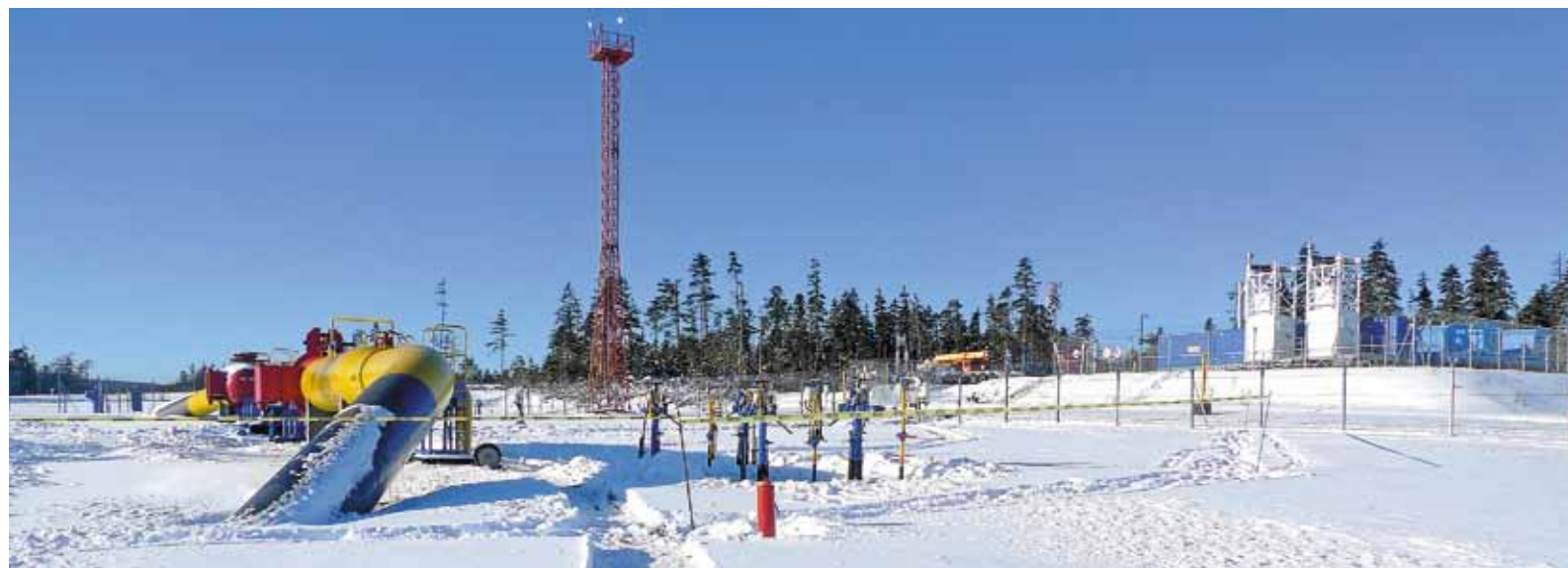
Мыс Каменный: узел приема-запуска очистных устройств Амурского филиала
