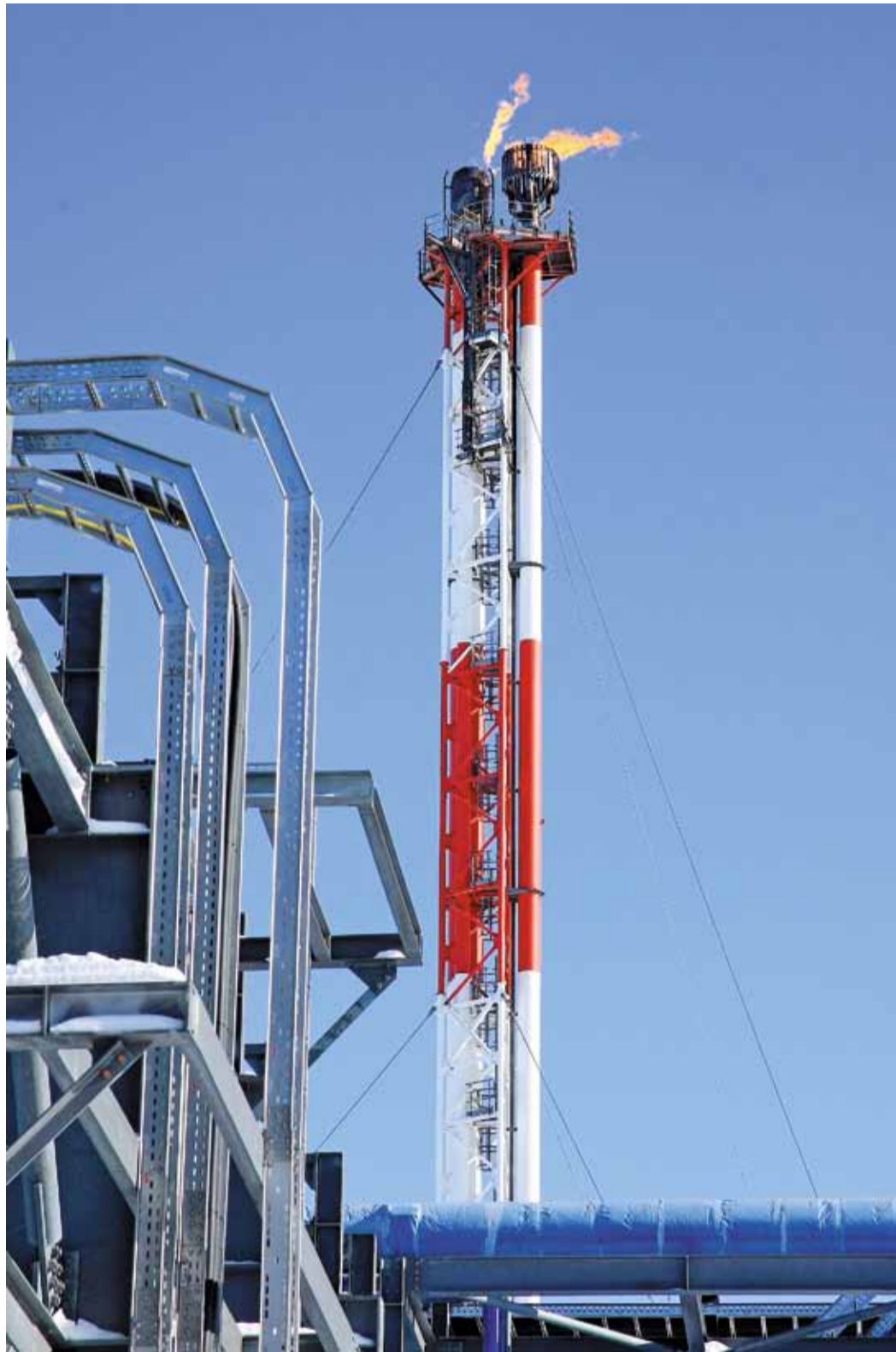
На ОБТК поступает нефть и газ сразу с двух сахалинских месторождений
