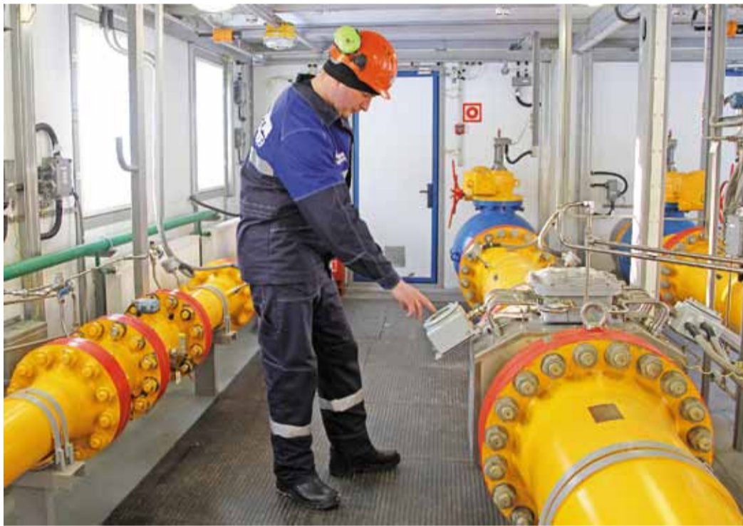
Оператор ГРС Евгений Шелудяков контролирует работу оборудования
