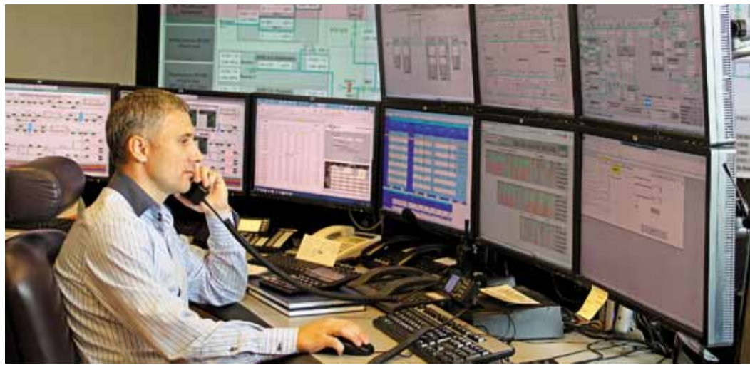
Дальневосточный региональный диспетчерский пункт в Хабаровском ЛПУМГ
