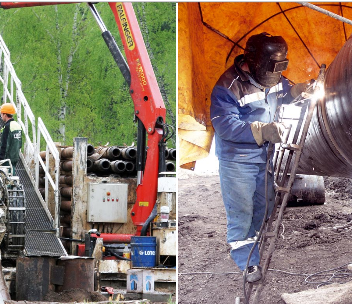
↑ К 2011 году газотранспортная система «Газпром трансгаз Томск» будет соответствовать всем современным требованиям
