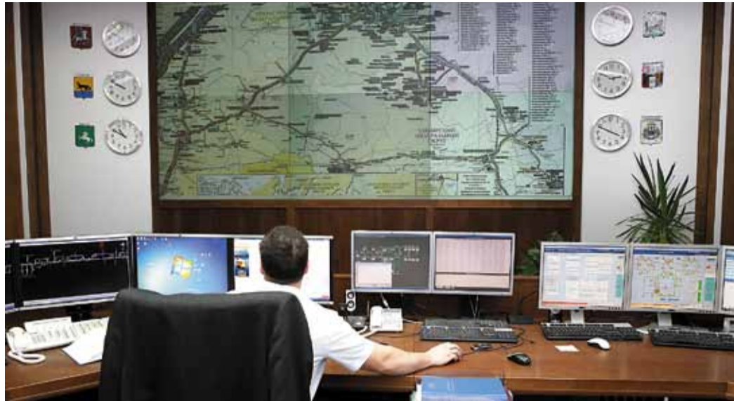
Диспетчерская ООО «Газпром трансгаз Томск»: здесь не просто видят магистральные газопроводы, но и управляют процессом транспорта газа
